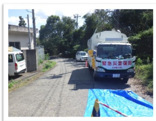
電源車による電力供給状況 (竹岡増圧ポンプ場)
