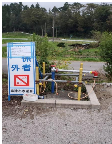
拠点給水所 (峰上公民館)
