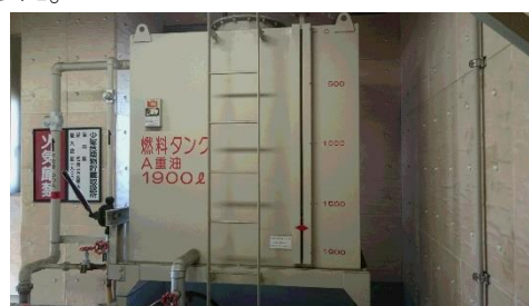
自家発電設備用燃料タンク (本庁舎)
