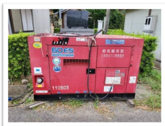
可搬型発電機設置状況 (大田和加圧ポンプ場)
