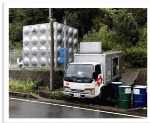
電源車による電力供給状況 (豊岡第三増圧ポンプ場)
