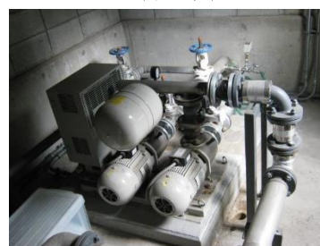
増圧ポンプ設備 (富来田第四加圧所)
